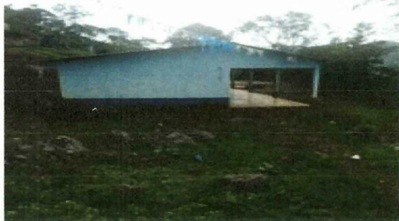
Foto 1: Muro de mampostería y columna de corredor agrietado, se debe reparar.
